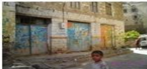
شكل (23) يوضح حاجة الأرضية للترميم والصيانة
